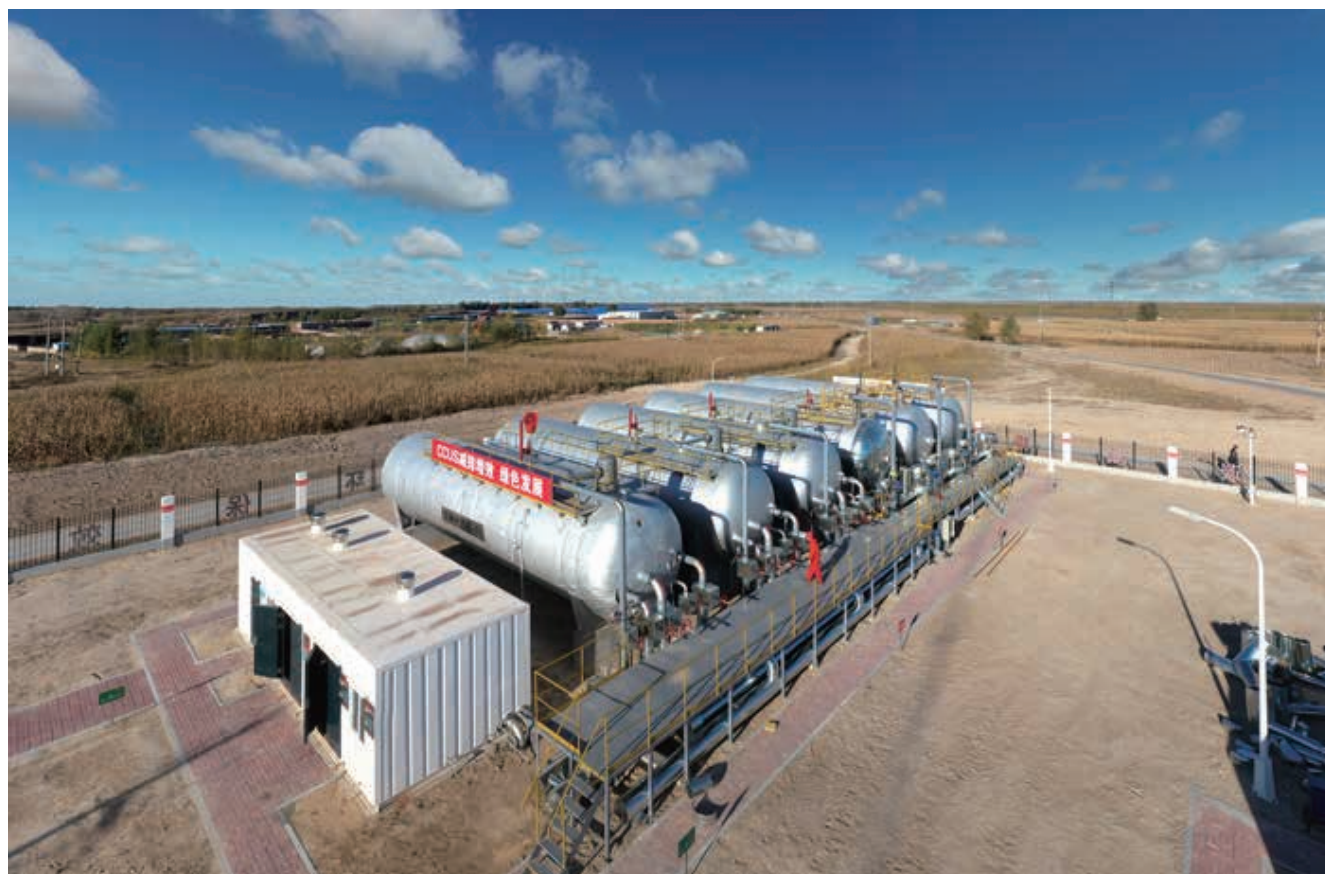
中国石油吉林油田 CO 2 注入现场，吉林松原（照片来源：中国石油天然气集团公司）
