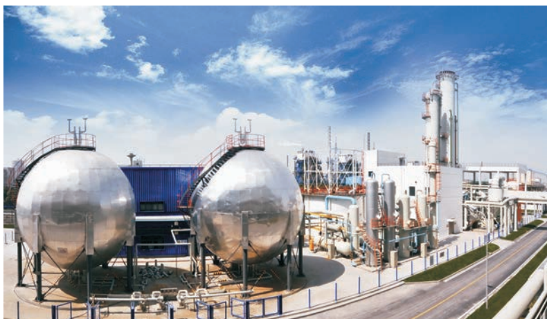
上海石洞口 120,000 吨 / 年二氧化碳捕集装置
